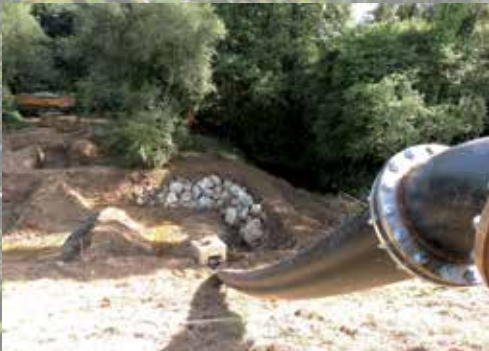
Mise en place du siphonnage vidange par gravité
