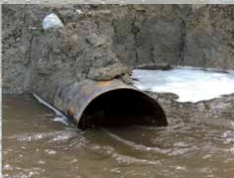
Buse d'entrée de digue de 500mm de diamètre et 25m de long sous la digue
